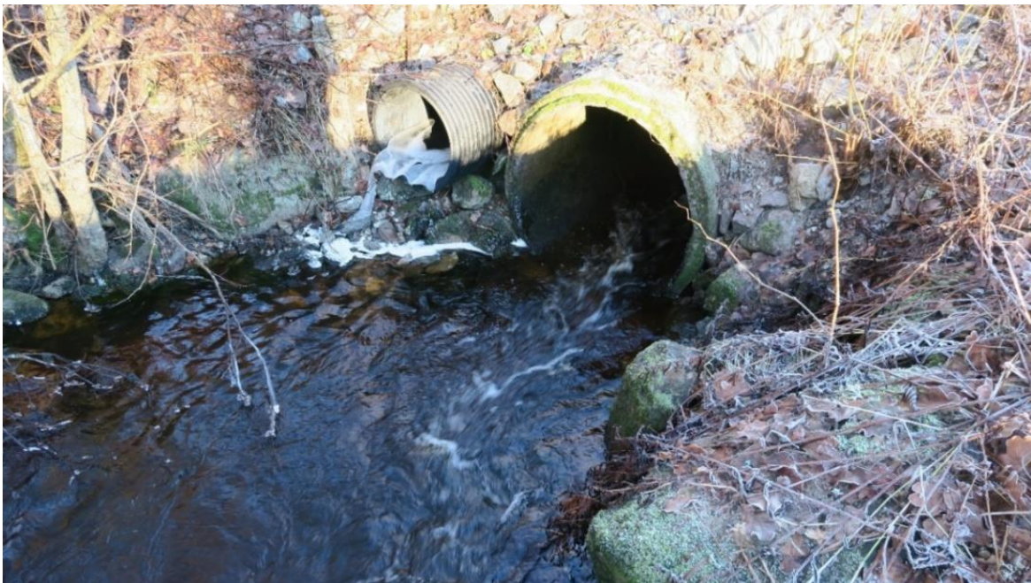
Bild 15. Vägtrumma vid lokalväg vid Kråkeröd, ca 20 meter från sammanflödet med Taske å.
