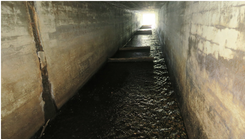
Bild 5. Inne i kulverten vid lågvattenföring 2018. Notera att flera tvärstockar lossnat.
