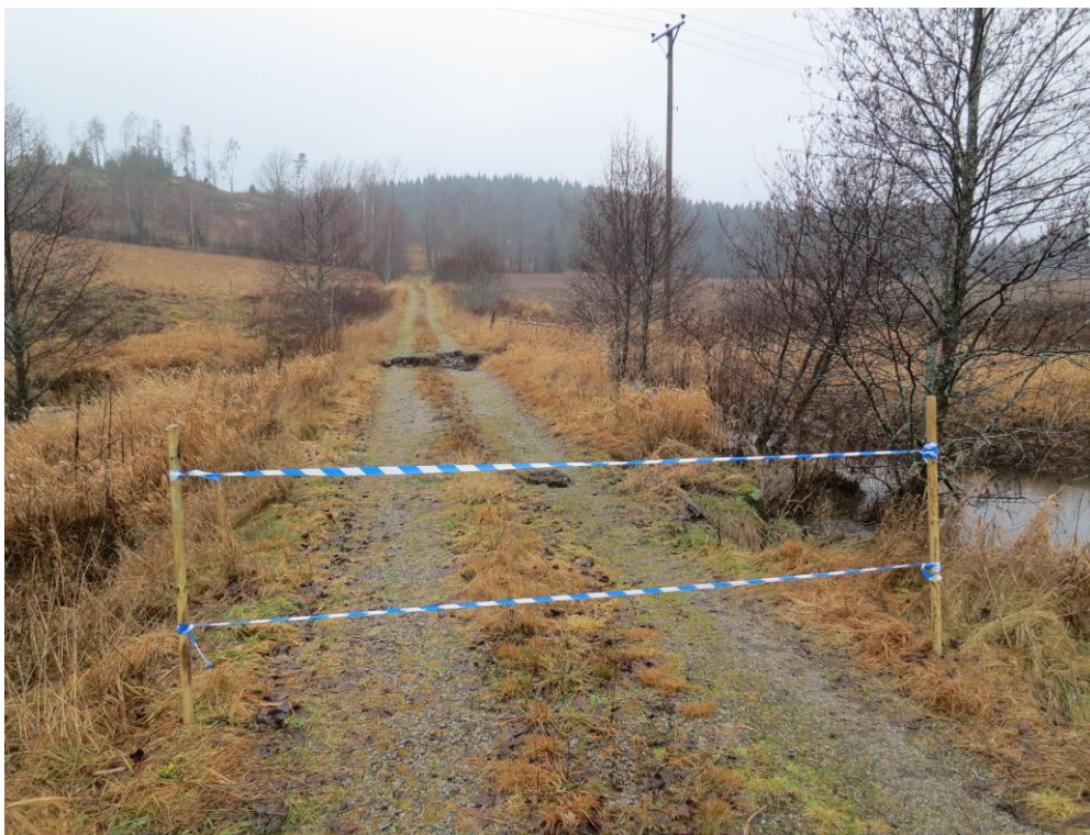
Bild 3. Vägen har spärrats av. Trumman på bild 1 är belägen strax innanför avspärningen. Erosionsskadorna syns ca 20 meter in på vägen.
