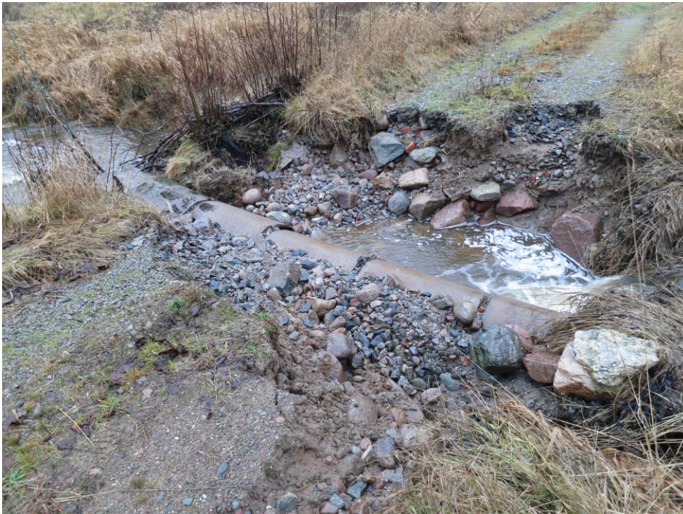
Bild 2. Bäckens har eroderat sönder vägen, höger (väster) om trumman i bild 1.
