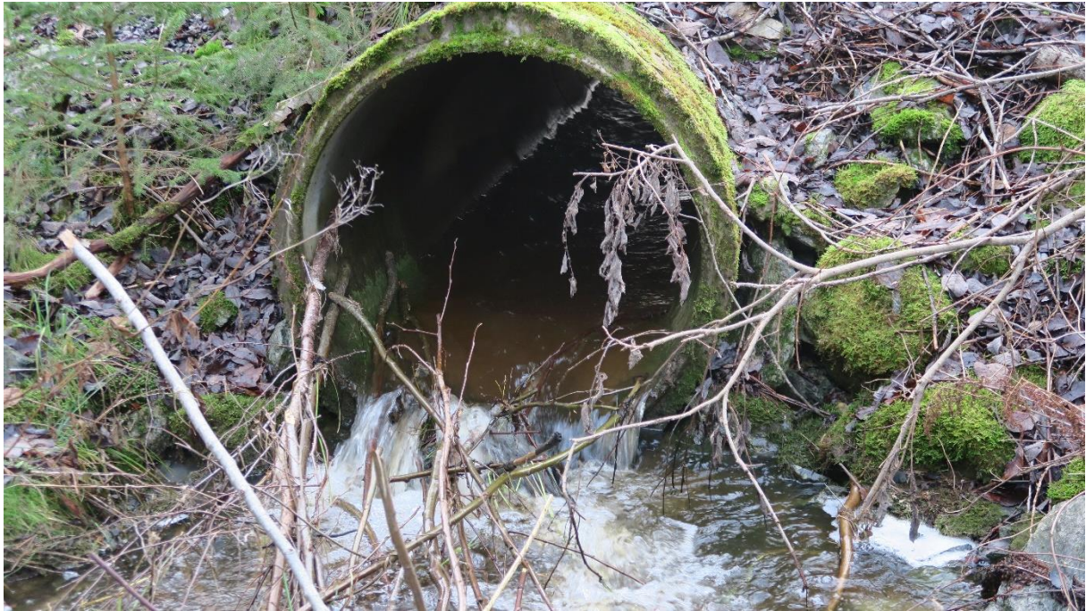
Bild 5. Vägtrumman vid Klockaredalen 2017. Utloppet.
