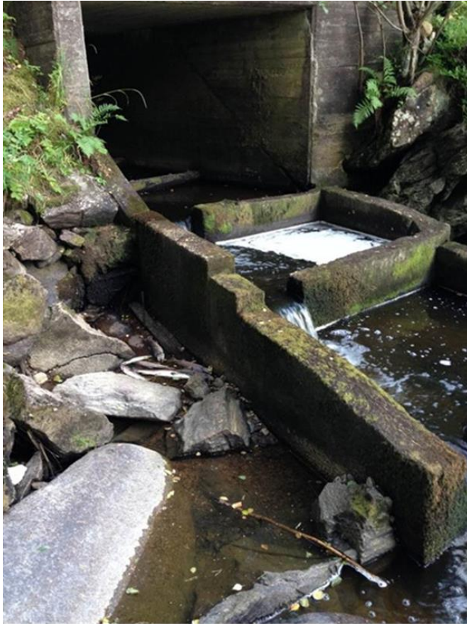
Bild 1. Fisktrappan i Taske å. Bilden tagen före åtgärd.
