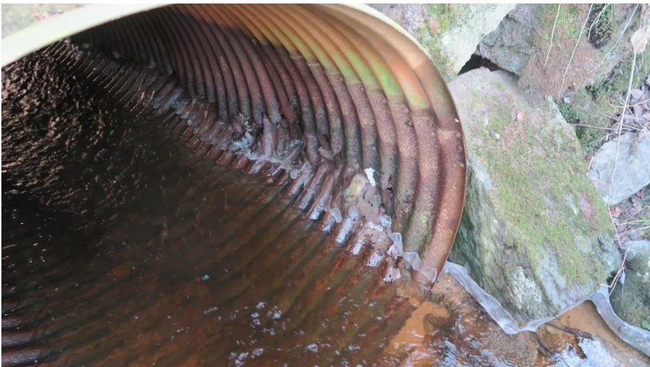
Bild 2. Den gamla vägtrumman vid Hästhagen. Trumman var även kraftigt rostskadad.
