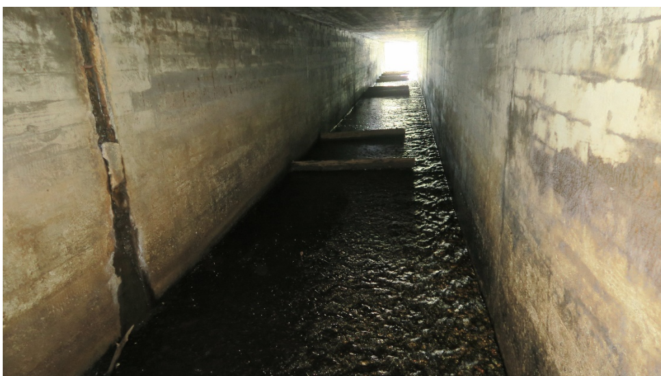
Bild 2. Befintligt utseende inne i kulverten (2018-08-01). Notera att vissa tvärstockar lossnat.
